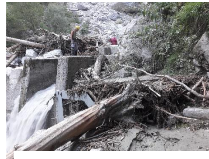
Eboulement sur la prise d'eau
